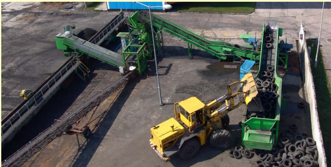
Linia do rozdrabniania opon samochodowych na terenie ciepłowni C-3
